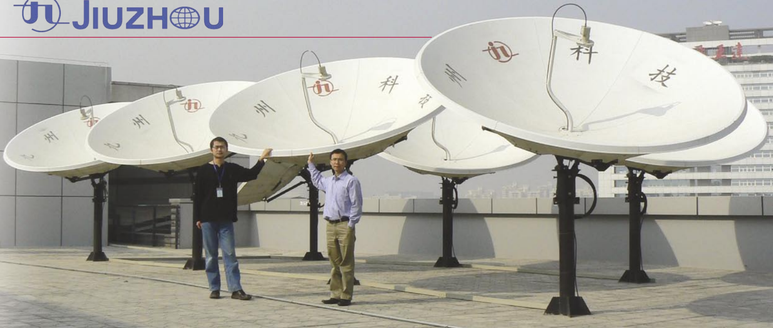
▲ 在九州电器大厦的屋顶上:来自他们自己生产线的七个天线,安装得非常专业化,以便让开发工程师以最大的信号强度接收所有可能接收到的卫星。在这里可以看见负责管理大楼的岳萌和一名开发工程师。
