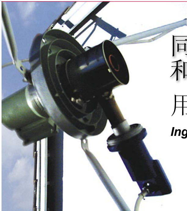
现实中，C/Ku复合馈源安装在一面1.80M的天线上，正在接收 72°E 上的 PAS4
