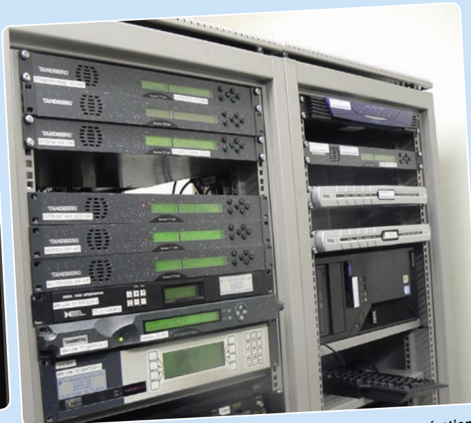
Les signaux sont traités ici. Les slots Tandberg sont pour des opérations satellite. Les slots pour les ondes radio terrestres relient avec SENTECH, le fournisseur de services africain pour la distribution de signaux.
